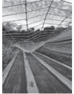
風で骨組みがつぶされたビニールハウス（9月、大島町）
